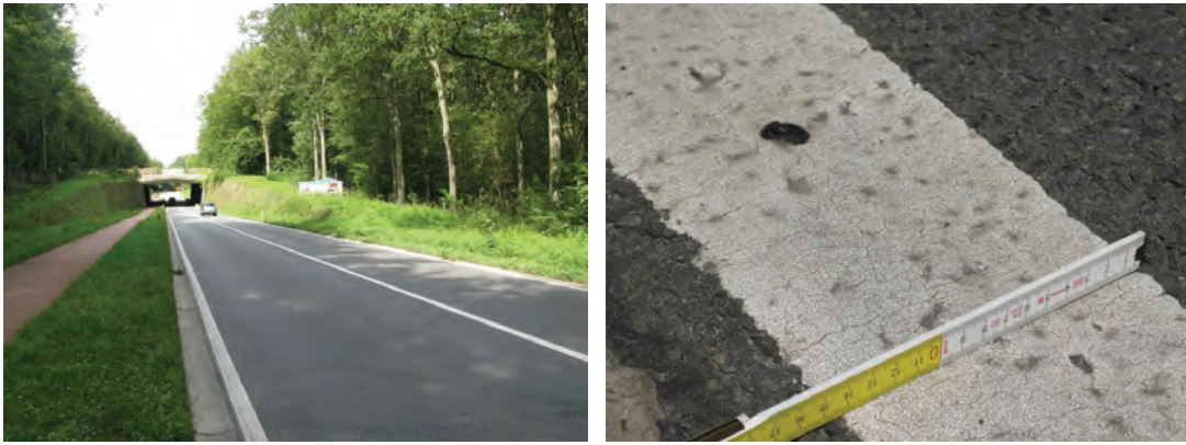
11. Measurement point MP9: N25 Naamssteenweg-Oud-Heverlee, edge line.
